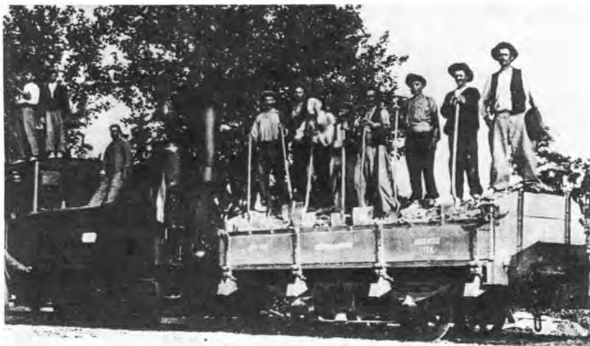
Ligne d'Olonzac à Félines Hautpoul : train de ballast lors de la construction en juillet 1908 ; matériel de l'entreprise Jules Weitz, de Lyon (locomotive Pinguely et wagon).
